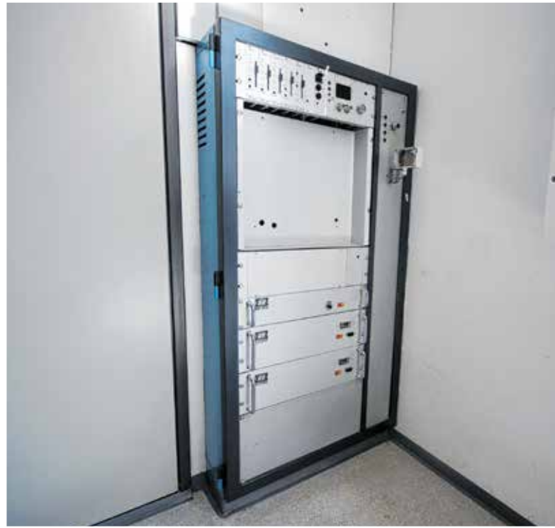
Das Zentrale des bisherigen Systems. Foto: Simon Wagner
